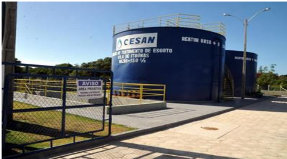
Figura 2. Reatores UASB ETE em Itaúnas, Conceição da Barra. Fonte: CESAN, 2013.
