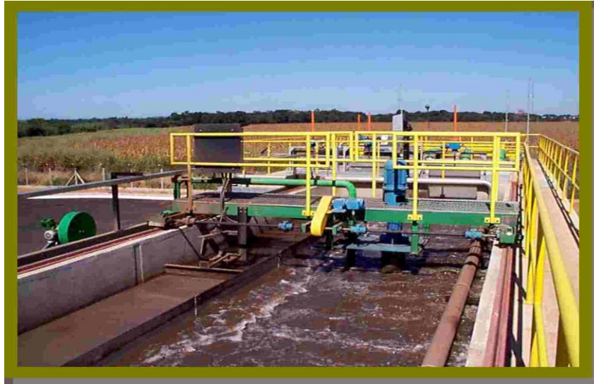
Figura 5. Tanques desarenadores. Fonte: Universidade Estadual de Campinas, 2019.
